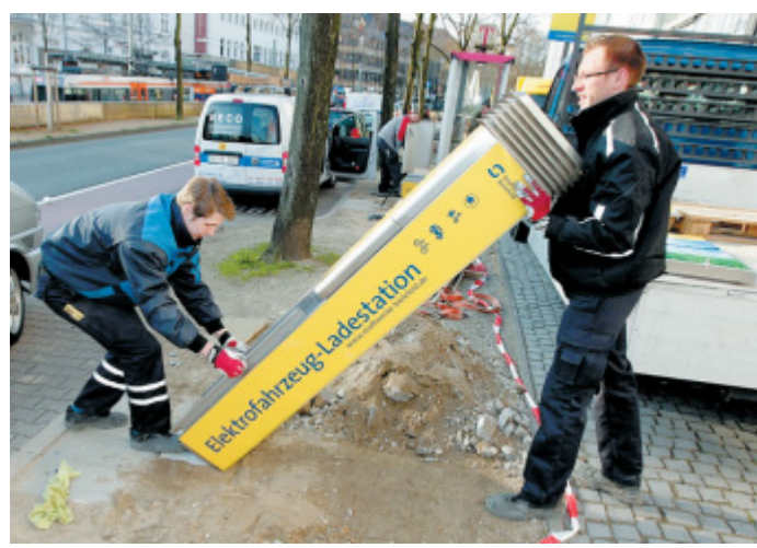
An der neuen Säule: Fabian Beinlich (links) und Sergej Lange installieren eine der zwei neuen Säulen am Niederwall. FOTO: WOLFGANG RUDOLF
